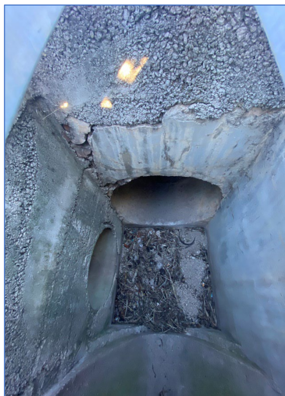
Pou aigües avall OD. Connexió al drenatge urbà.
